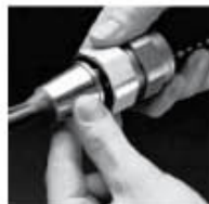
4.- Deslice el tope de la armadura sobre el conductor y selle con el compuesto, después regrese contra la armadura. Rellene manteniendo el compuesto sellador.
